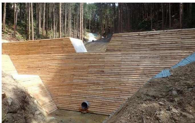
R 4 熊取町野田（治山ダム）
