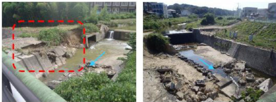
平成24年8月豪雨（国道1号上流）
