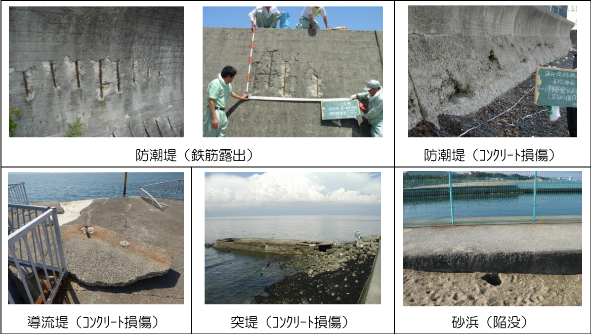
図 3.1-9 主な海岸施設の劣化状況
