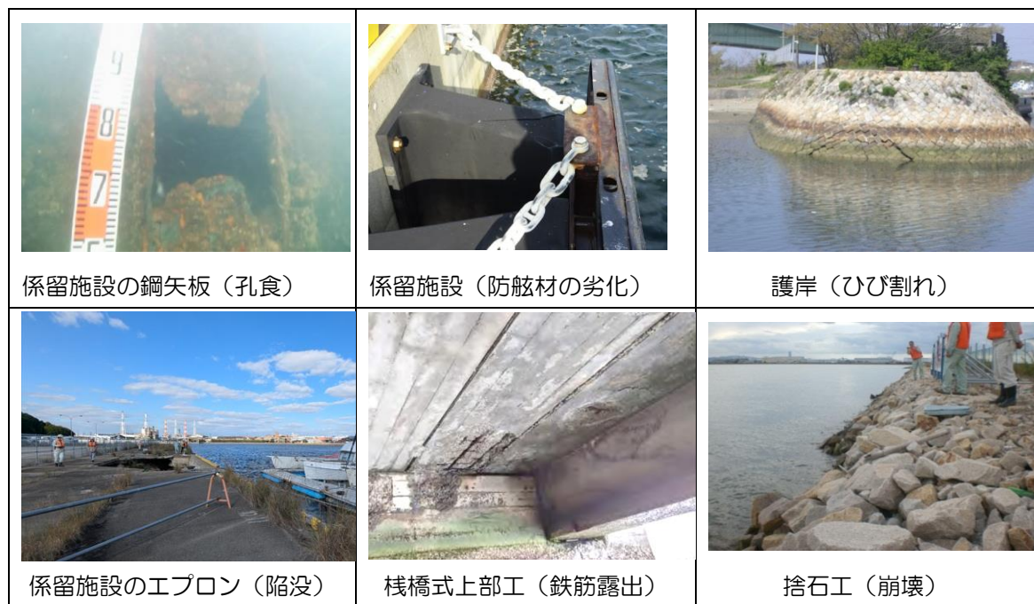
図 3.1-5 主な港湾施設の劣化状況
