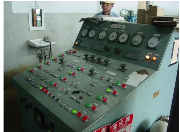
電気設備の陳腐化
