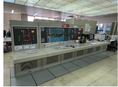
監視制御設備
