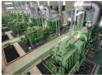
雨水ポンプ設備
