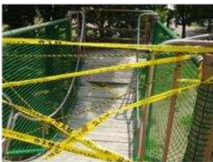
劣化による破損（利用停止）
