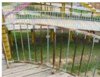
劣化による腐食
