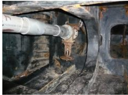
水門扉体内面の腐食状況
