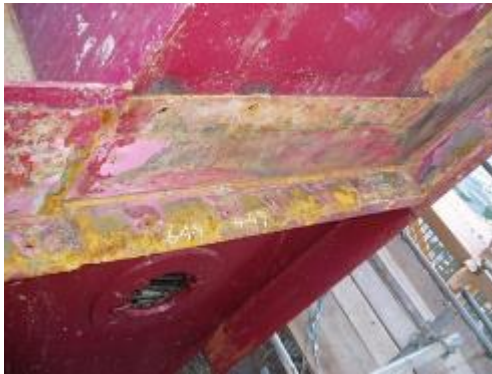
水門扉体の腐食状況
