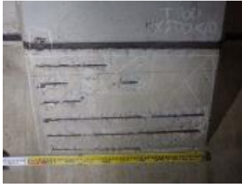
鉄筋露出（長瀬調節池）
