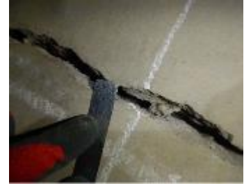
ひび割れ（今川立杭）
