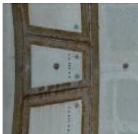
上記（鋼材の発錆）の 拡大写真
