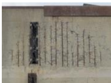
剥離・鋼材露出
