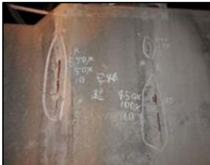
剥離・鉄筋露出
