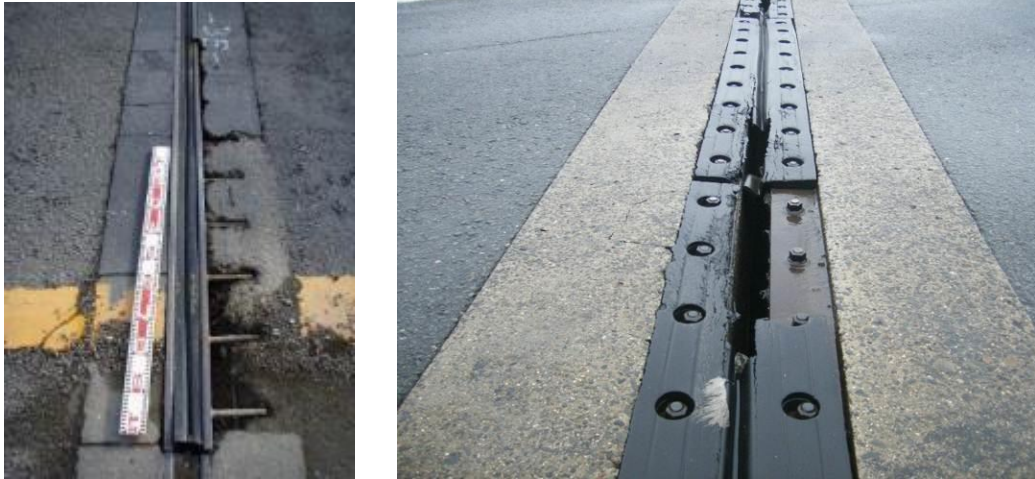
図 3.1-20 損傷ジョイントの様子
