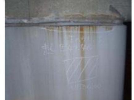
補強材の腐食
