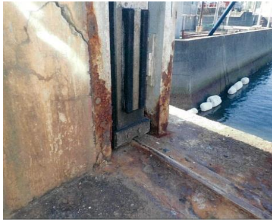
防潮扉の腐食
