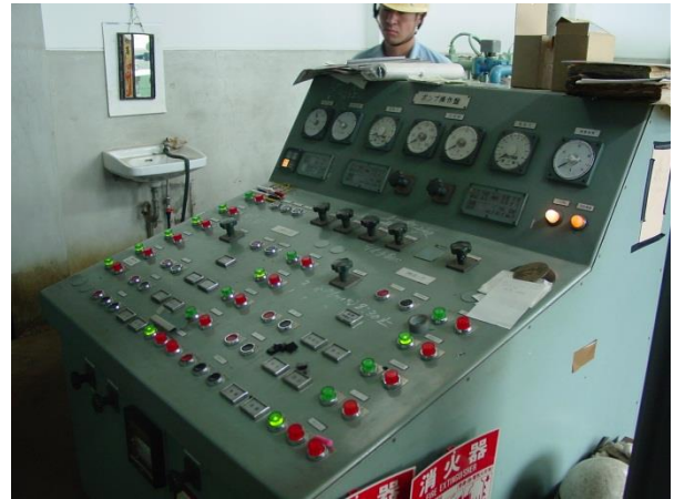
電気設備の陳腐化
