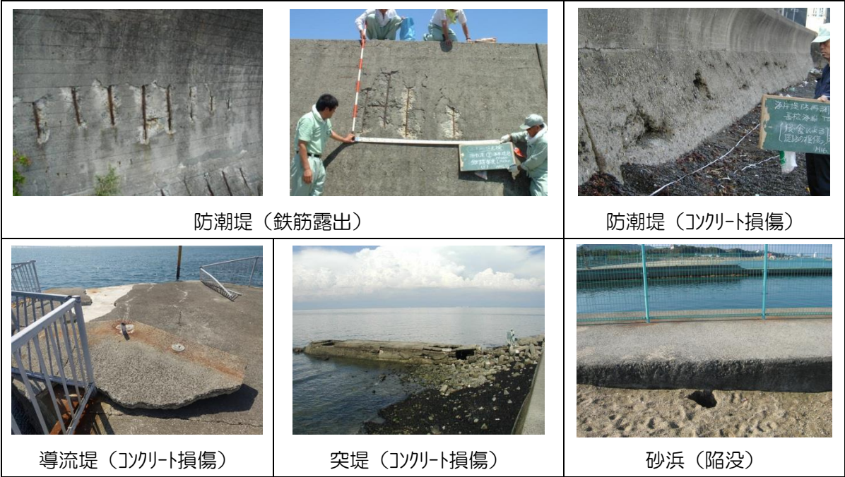
図 3.1-9 主な海岸施設の劣化状況
