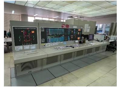
監視制御設備
