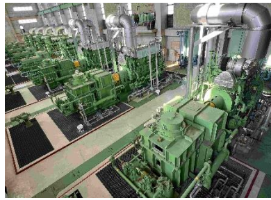
雨水ポンプ設備
