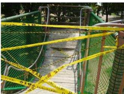
劣化による破損（利用停止）
