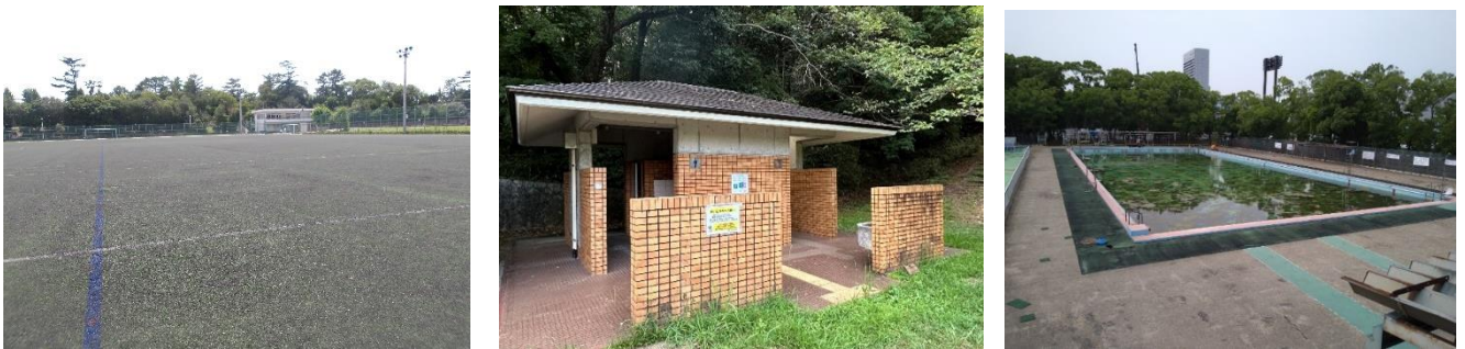
図 3.5-1 公園サービス施設等の劣化状況
