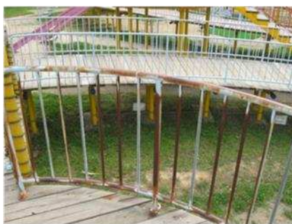
劣化による腐食
