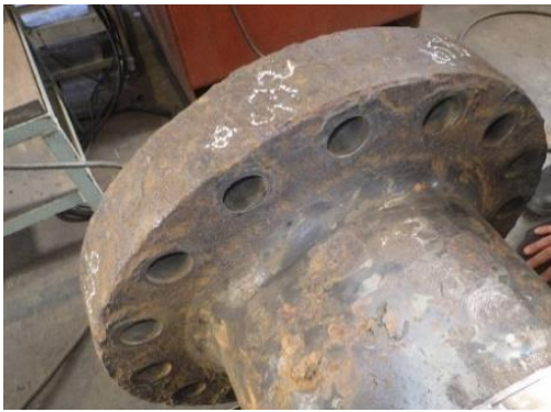
ポンプ軸の腐食状況
