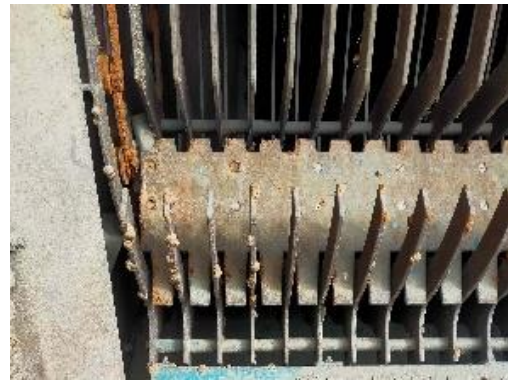
除塵機の腐食状況
