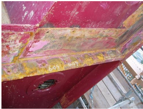
水門扉体の腐食状況
