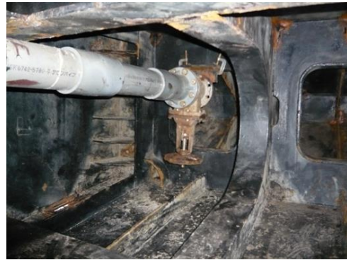
水門扉体内面の腐食状況
