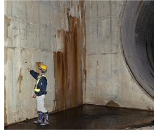
漏水・錆汁（美園立坑）
