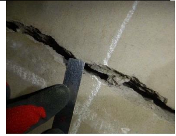
ひび割れ（今川立杭）
