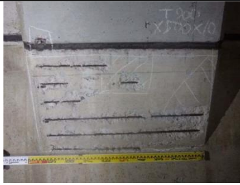
鉄筋露出（長瀬調節池）
