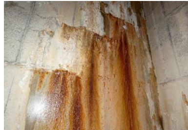
上記（漏水・錆汁）の 拡大写真
