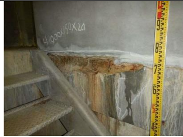
剥離（大正川調節池）
