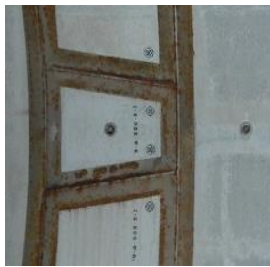
上記（鋼材の発錆）の 拡大写真
