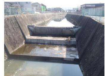
(ゴム引布製起伏堰(参考))
