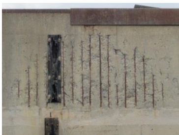
剥離・鋼材露出
