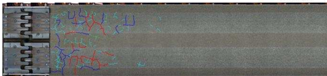
PC 軌道桁のひびわれ
