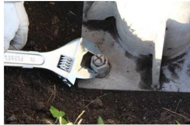
図 3.7-2 ボルト・ナットの増し締め
