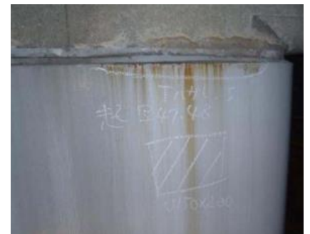
補強材の腐食
