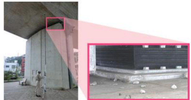
図 3.9-21 点検ロボット
