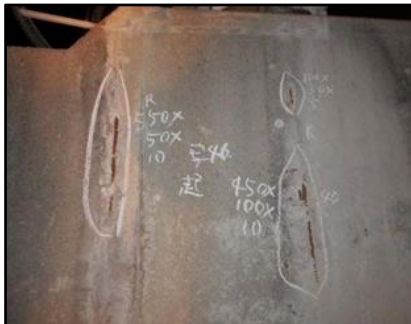
剥離・鉄筋露出
