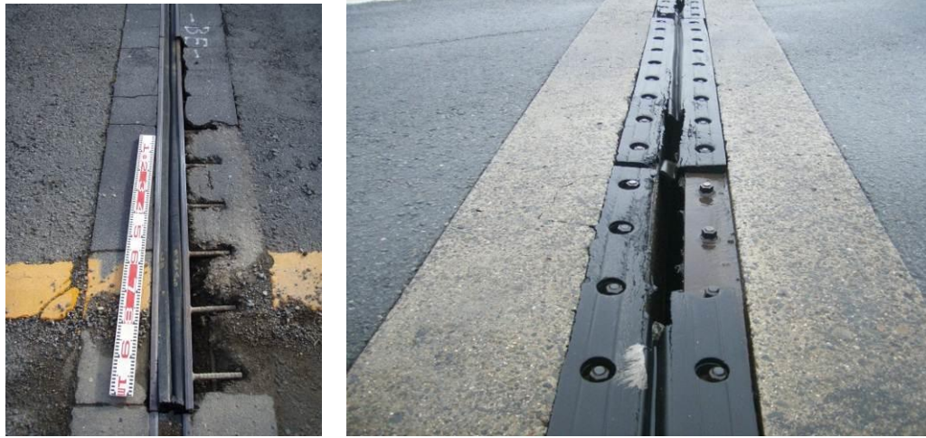
図 3.1-20 損傷ジョイントの様子
