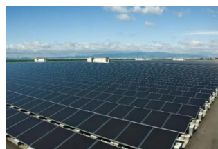
太陽光発電施設
