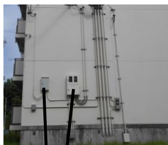
① 幹線ナイフスイッチ・ヒューズブレーカー (引込盤及び分電盤を含む)
