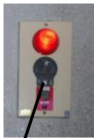
②非常警報ベル及び押ボタン
