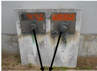
①連結送水口（消防隊専用）
