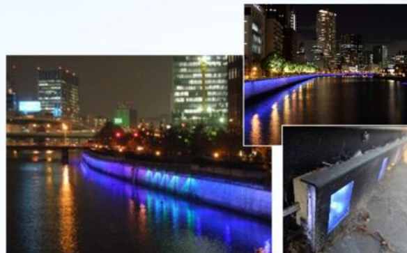
護岸照明施設（大川、堂島川）
