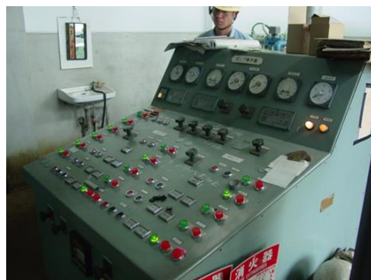
電気設備の陳腐化
