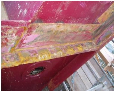
水門扉体の腐食状況
