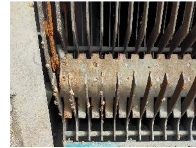
除塵機の腐食
