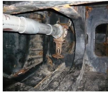
水門扉体内面の腐食状況
