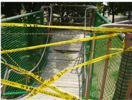
劣化による破損（利用停止）
