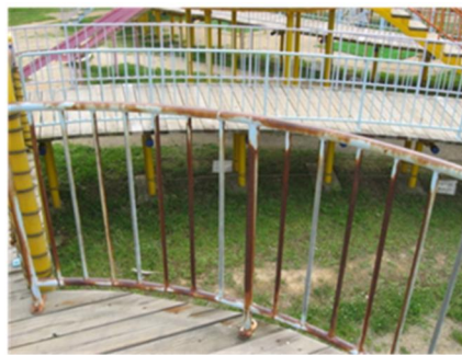
劣化による腐食
