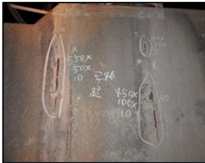
剥離・鉄筋露出
