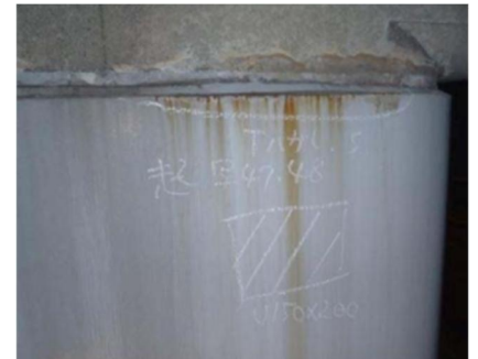
補強材の腐食
