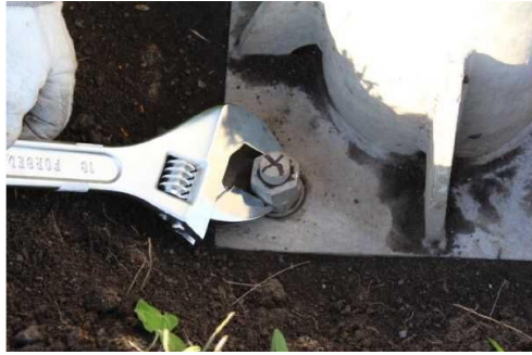
図 3.7-2 ボルト・ナットの増し締め
