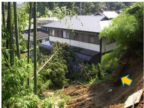
H19年台風第4号及び梅雨前線 がけ崩れ（河内長野市）
