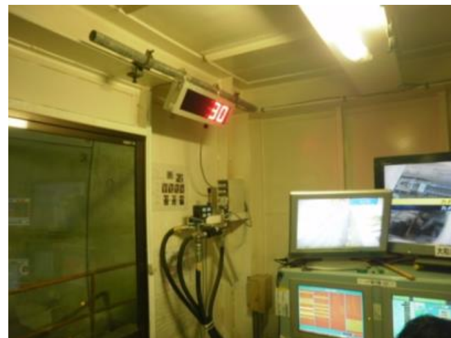
シールド操作室(機内) の振動レベル表示(イメージ)
