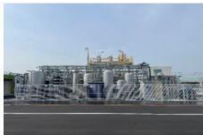
メタネーション実証設備/大阪ガス株式会社 環境省委託事業「既存のインフラを活用した水素供給 低コスト化に向けたモデル構築・実証事業」
