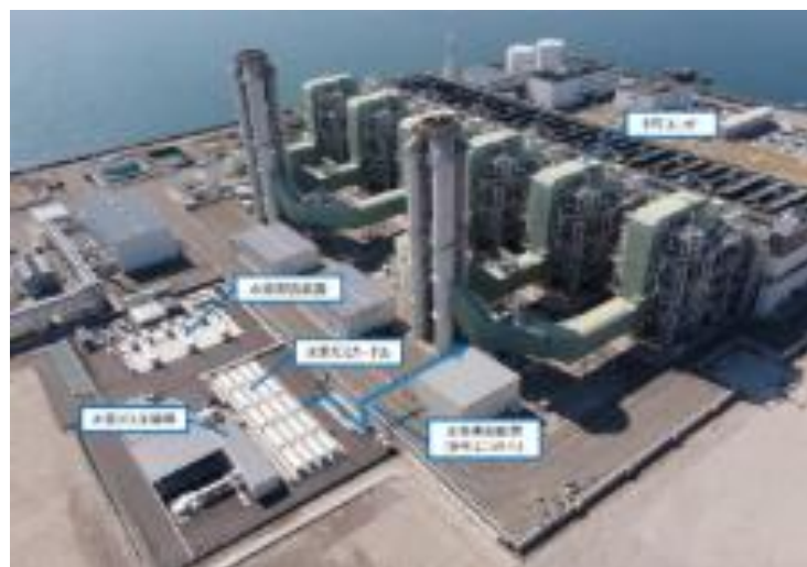
水素混焼発電設備/関西電力株式会社
