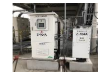
水素充填ユニット
