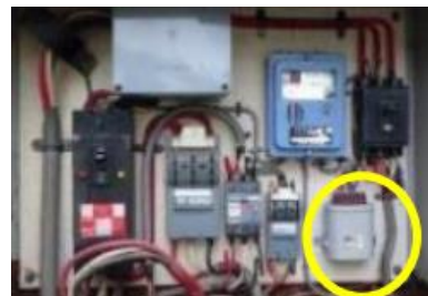
低圧分電盤内の 低圧コンデンサー
