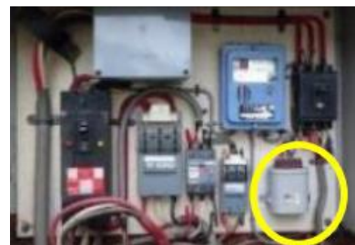
低圧分電盤内の 低圧コンデンサー
