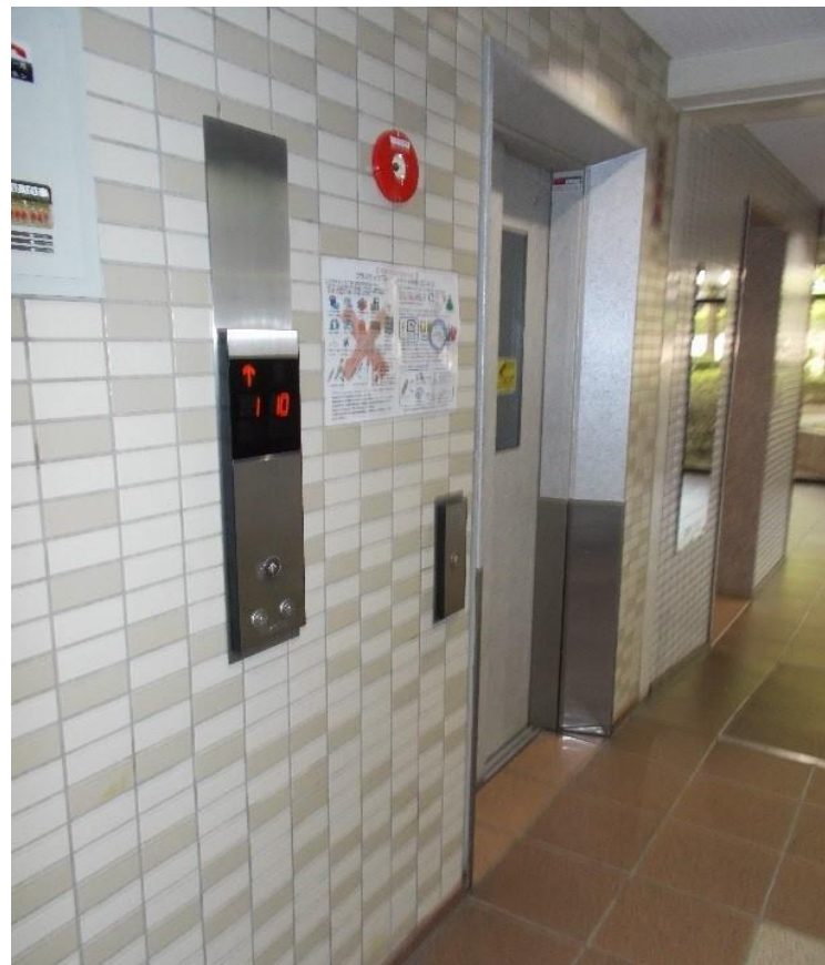
エレベーター
