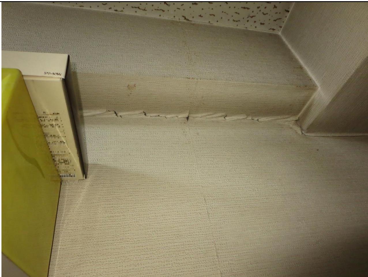
⑨クロス剥がれ（玄関付近）
