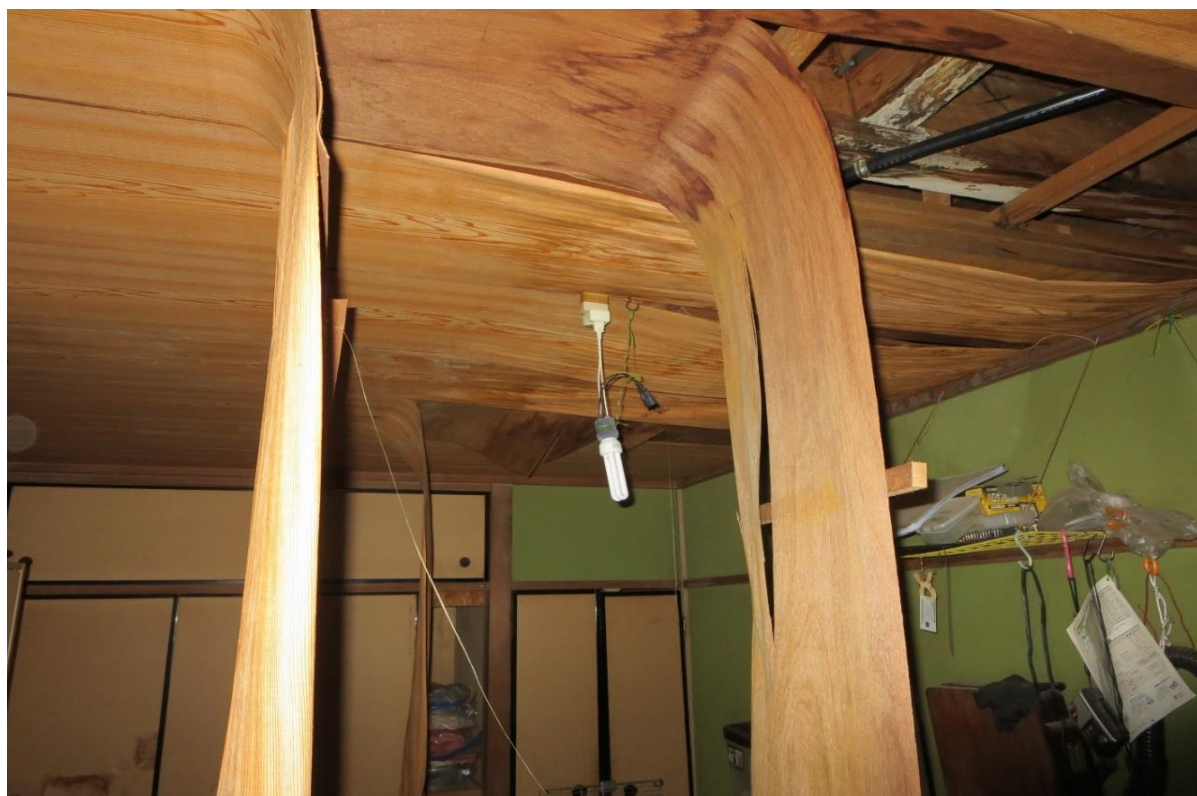
⑤ 1階奥 和室 天井板の剥がれ 拡大
