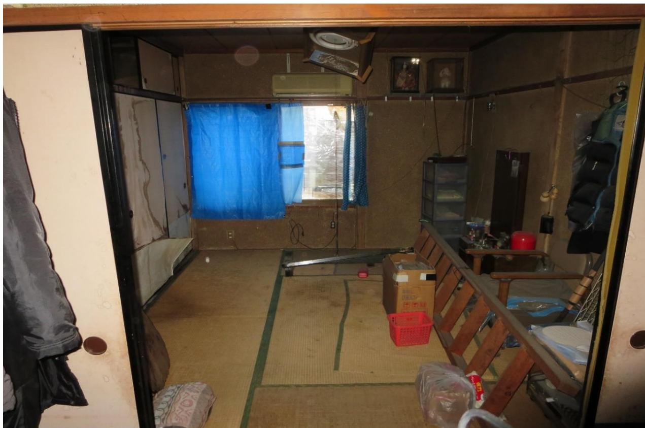
⑧ 2階奥 和室 雨漏り箇所
