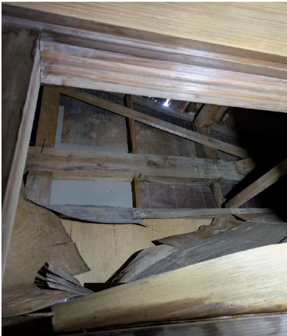
⑨ 2階奥和室 押入上部 屋根の破損部
