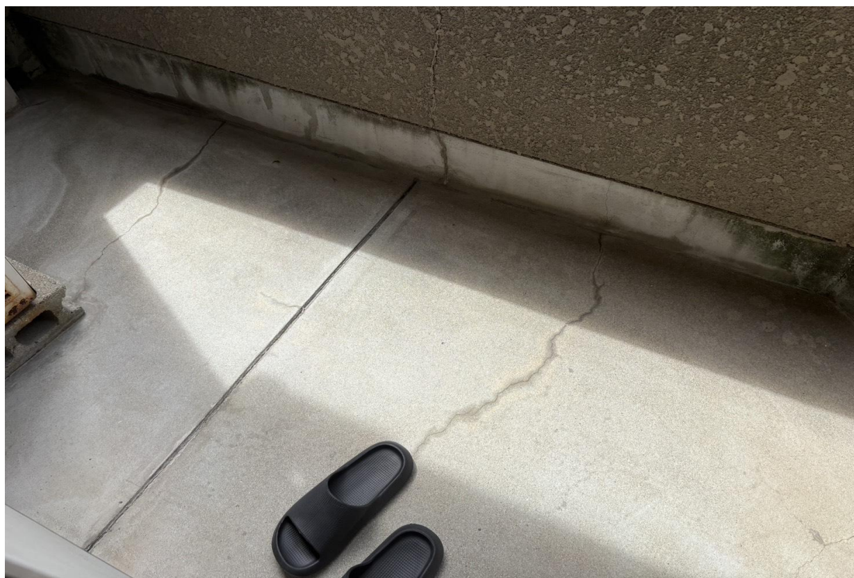
⑫3階南側バルコニー（コンクリートのひび）
