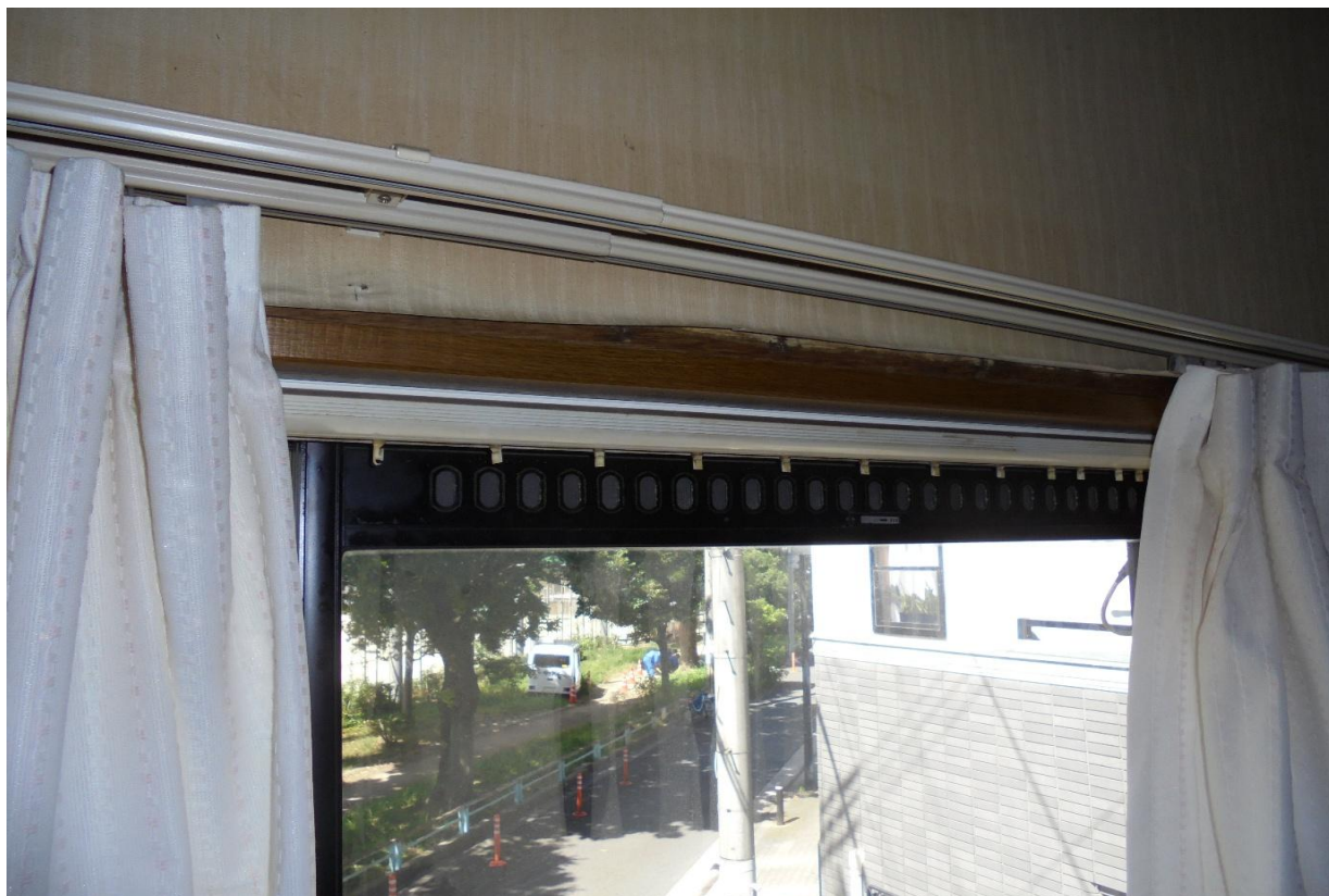
⑪2階リビングダイニング（南西側窓枠の雨漏り跡）
