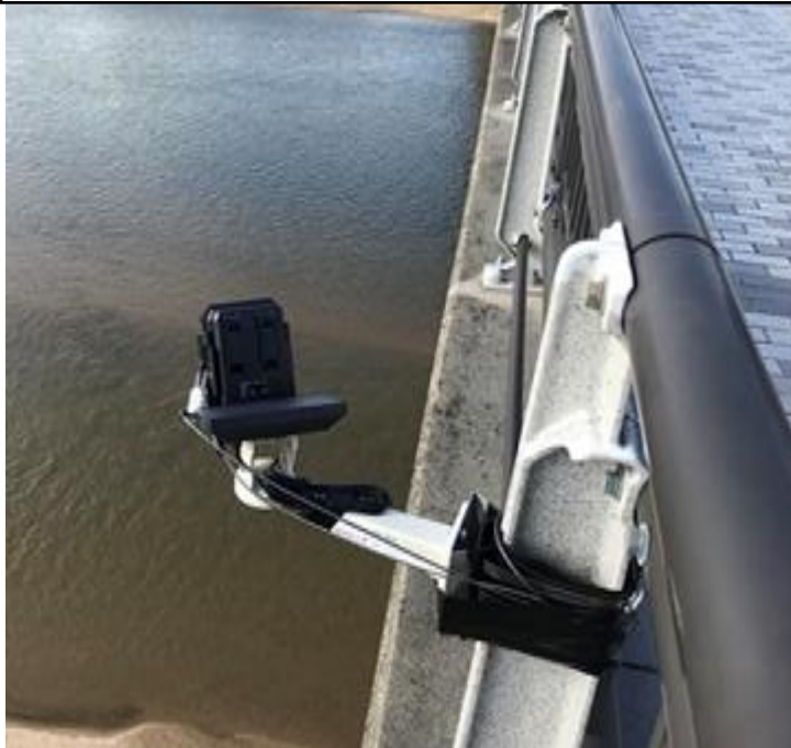
カメラの設置状況（木津川）
