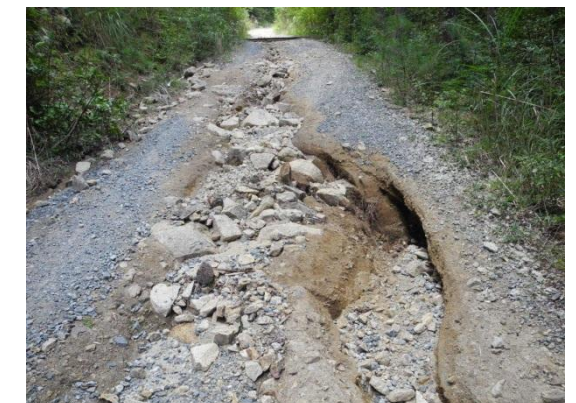
荒廃した作業道 (能勢町の事例)
