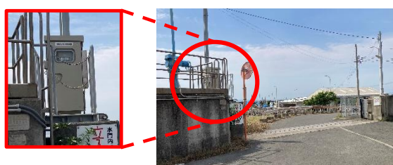
防潮鉄扉の遠隔監視装置（西鳥取漁港海岸）
