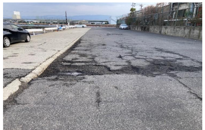
写真－3 護岸背後地舗装老朽化状況
