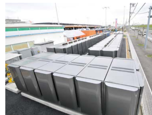
1.2兆瓦燃料电池 (SOFC) (2015年3月开始提供)
