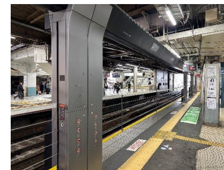
写真3：可動式ホーム柵整備状況 （近鉄 鶴橋駅）
