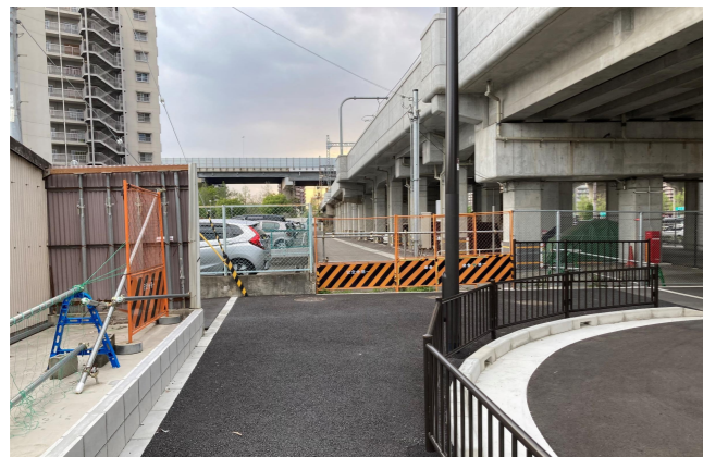
①側道未整備箇所
