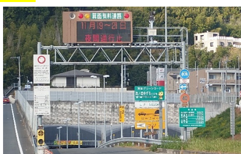
道路情報板設備（更新）
