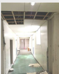
天井、内壁の落下
