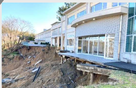
校舎前地盤が崩れ、地中杭が露出
