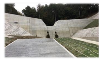
土砂災害対策施設の整備（砂防堰堤） 出典：大阪府都市整備中期計画
