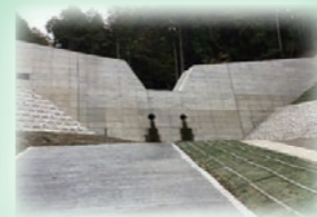
土砂災害対策施設の整備(砂防堰堤) 出典:大阪府都市整備中期計画
