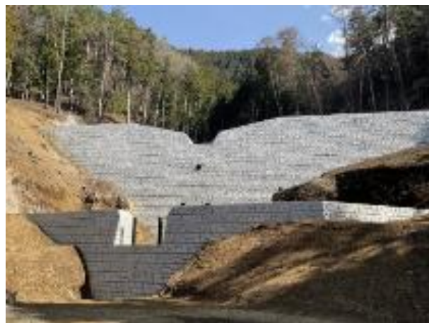
階段状設置 + 流木捕捉式の治山ダム
