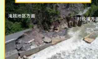
村道38号線被災状況
