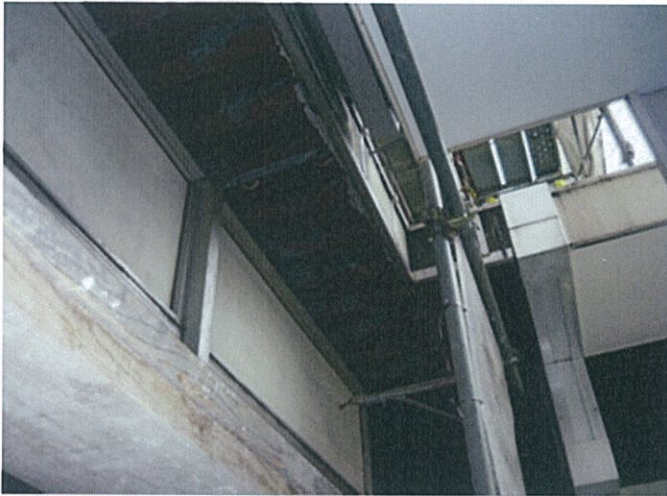
写真Ⅰ. 3階 軒裏吹付材の様子
