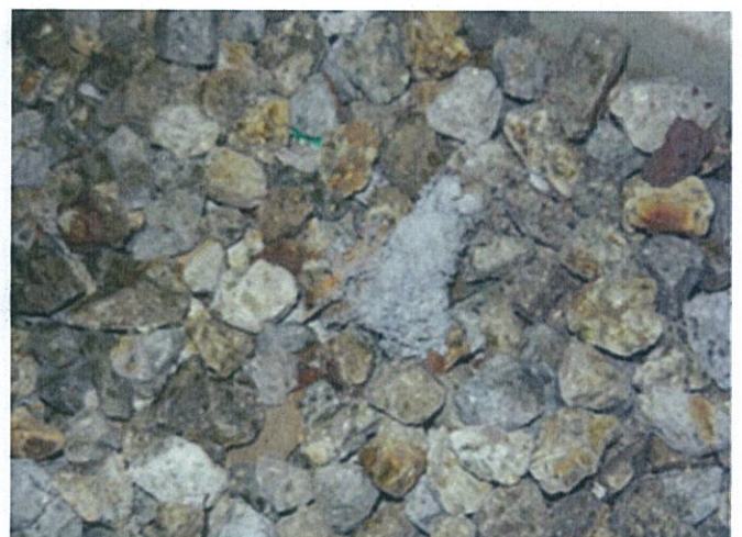
写真Ⅵ. 1階 足場周辺の青石綿
