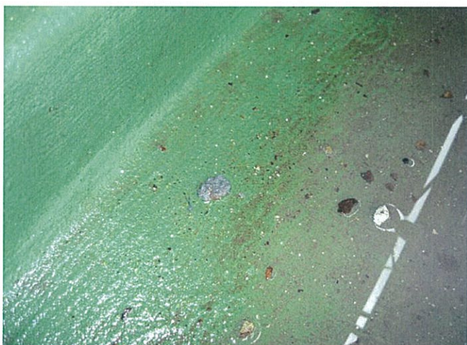
写真Ⅴ. 4階 渡り廊下の青石綿
