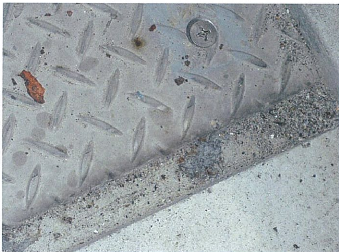
写真Ⅲ. EV前の青石綿
