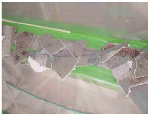
測定点2-3付近 ボード付着物
