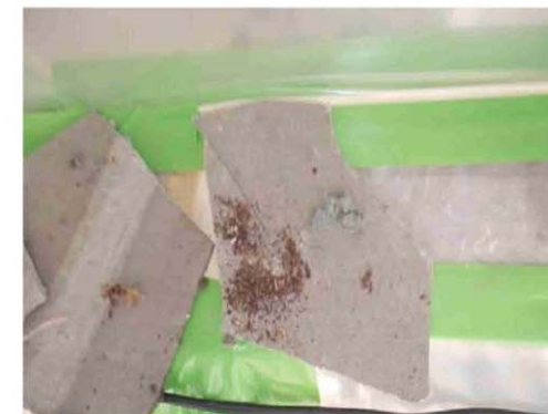
測定点2-1付近 ボード付着物
