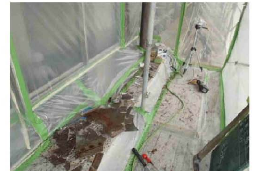
測定点1-1付近 ボード付着物
