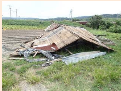
農小屋の被害(泉南市)
